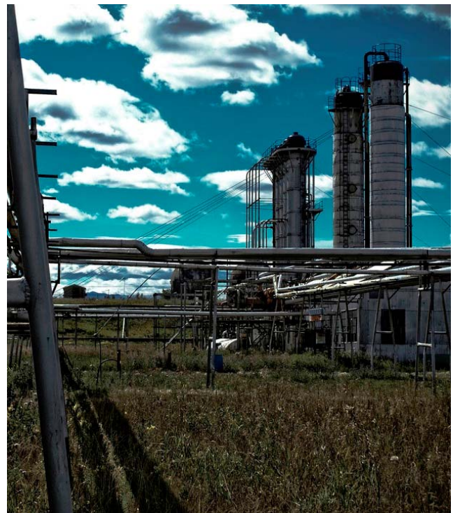
Instalaciones para la transformación industrial del Gas
